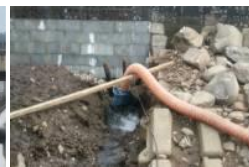
降雨降雪の排水ポンプ制御
