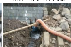
降雨降雪の排水ポンプ制御
