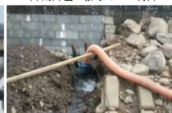
降雨降雪の排水ポンプ制御
